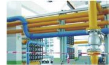
承接岱山县秀山海水淡化项目
